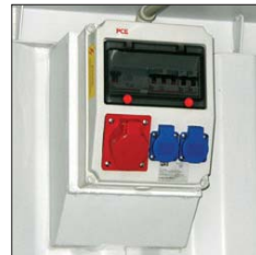
Verteilerkasten mit integrierten Steckdosen
