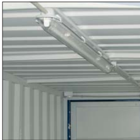
Leuchtbalken an der Decke und Zugschnurschalter neben der Tür
