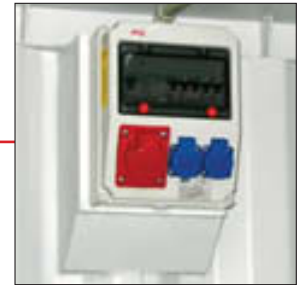
Verteilerkasten mit integrierten Steckdosen im Inneren des Containers
